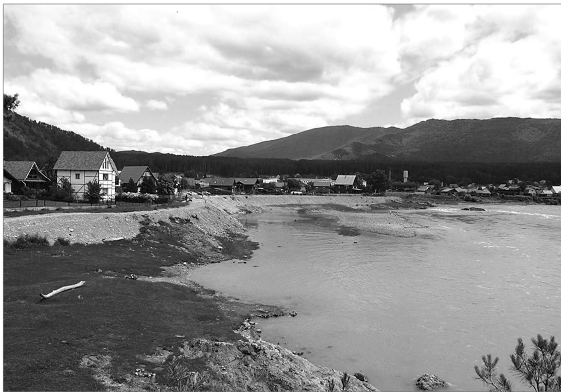
Рис. 3. Внешний вид отсыпки размываемого правого берега р. Катунь в с. Манжерок, июнь 2020 г.
